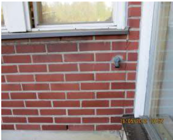
Seinässä on pieni halkeama.
