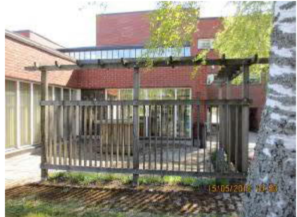
Pihan sidekivipinnat ovat paikoin päässeet sammaloitumaan. Kunnostus! Puuosien huoltomaalaus!
