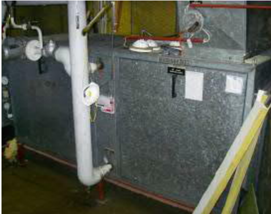
Tuloilmakoneet ovat alkuperäiset.
