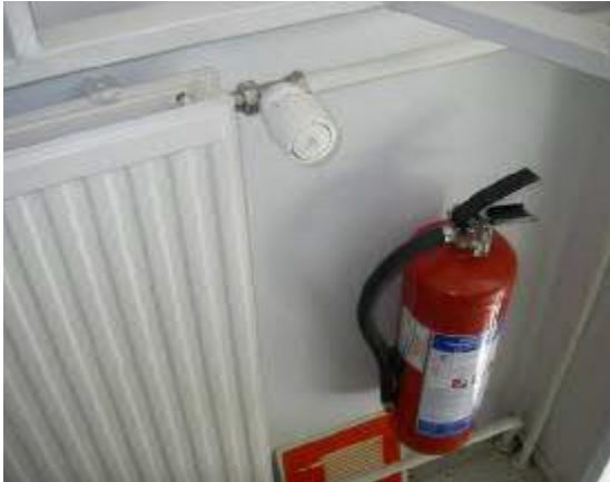
Termostaattiset patteriventtiilit ovat mallia Danfoss.
