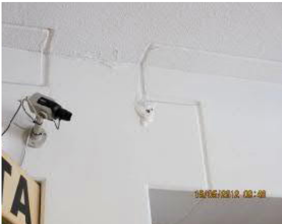
Seinässä on 'pussi' vuotokohdassa.
