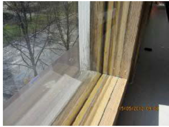
Ikkunoiden pinnoite oli huonokuntoista. Suositellaan uusimista.
