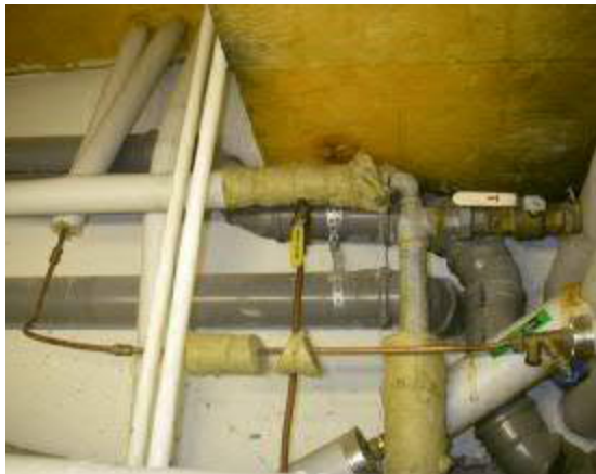
Kylmän veden runkoputket ovat galvanoitua terästä.
