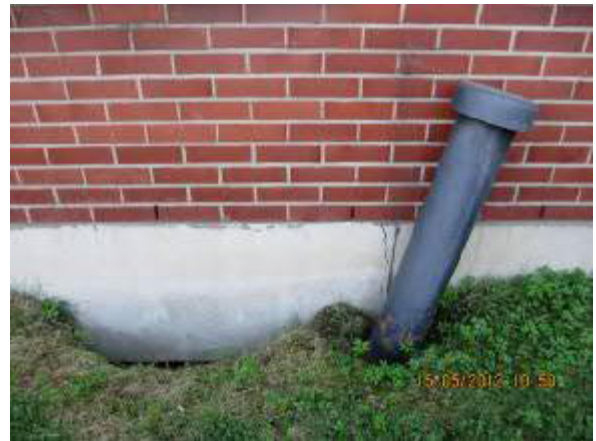
Sokkelissa on pieni halkeama.
