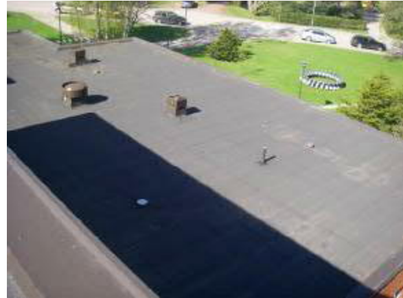
Kaikki kattorakenteet olivat silmämääräisesti kunnossa. Bitumihuopakate oli vuotanut mm. vastaanoton kohdalla. Huoltomies tietää paikan!
