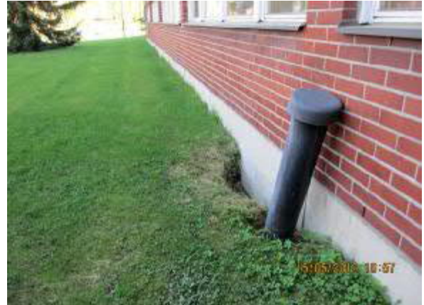
Kaadot sokkelien vieressä ovat paikoin huonossa kunnossa.
