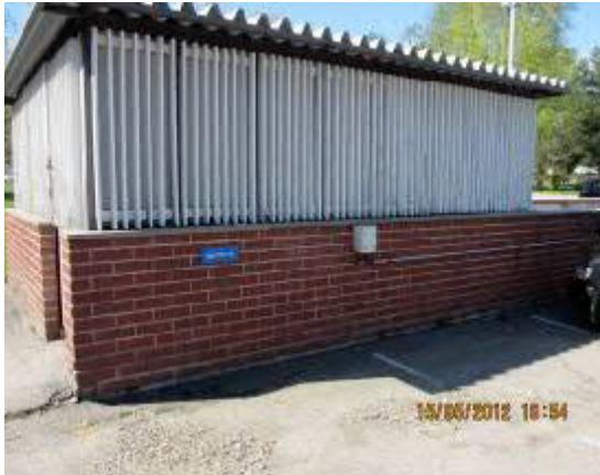
KJ: n autopaikka on painunut! Suositetaan korjausta.
