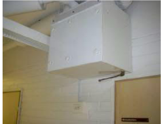
1. kerroksessa on yksi uudempi LTO kone.
