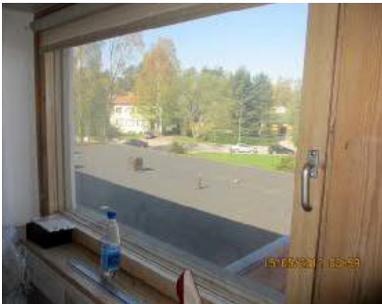
Ikkunat olivat pääasiassa sekä teknisesti että toiminnallisesti enintään tyydyttävässä kunnossa.
